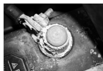
Conexión de cable corroído
